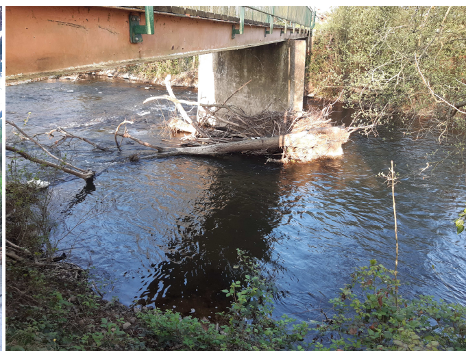
Embâcle à enlever sur la pile de la passerelle de l'aquarelle à St Jean sur Mayenne
